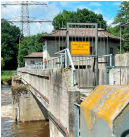
Die Wehranlage im jetzigen, sanierungsbedürftigen Zustand
